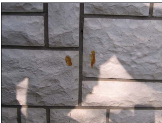
Slika 8: Pogled na razpoko in prvo stekleno plombo na vzhodni strani fasade objekta
