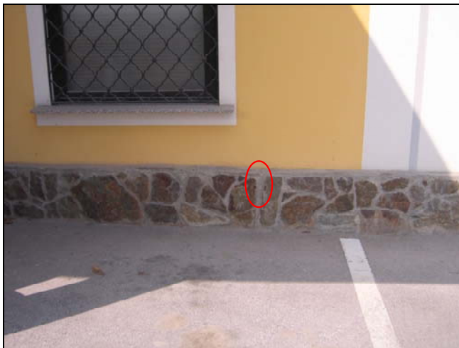
Slika 25: Lokacija razpoke na fasadnem podzidku
