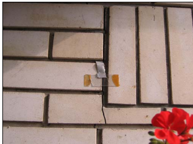
Slika 15: Pogled na razpoko in stekleno ploambo na južnem delu fasade objekta
