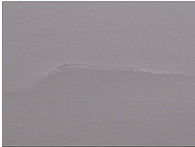
Slika 11: Razpoka na stropu v spalnici
