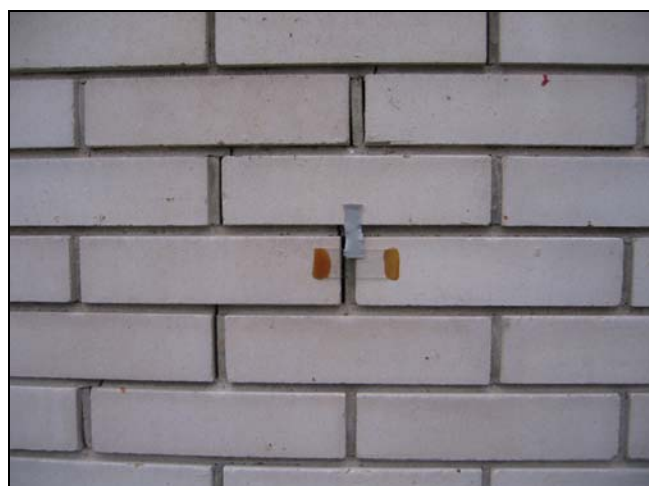
Slika 21: Pogled na razpoko in stekleno plombo na severnem delu fasade objekta
