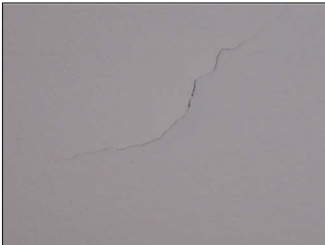
Slika 10: Razpoka na stropu v spalnici
