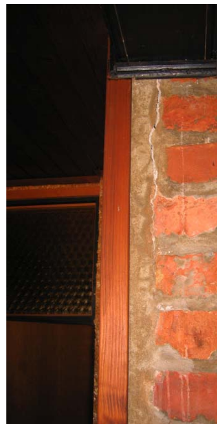
Slika 24: Razpoka na steni v dnevnem prostoru objekta
