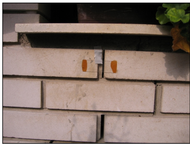
Slika 17: Pogled na razpoko in stekleno ploambo na vzhodnem delu fasade objekta
