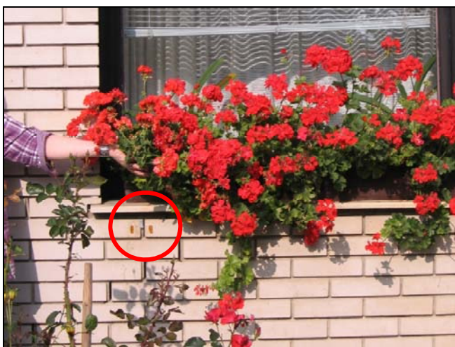
Slika 16: Lokacija razpoke na vzhodnem delu fasade objekta
