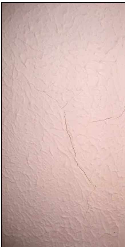
Slika 22: Razpoka na steni v dnevnem prostoru objekta
