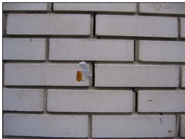
Slika 19: Pogled na razpoko in stekleno plombo na severnem delu fasade objekta
