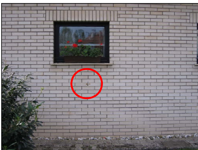
Slika 20: Lokacija razpoke na severnem delu fasade objekta
