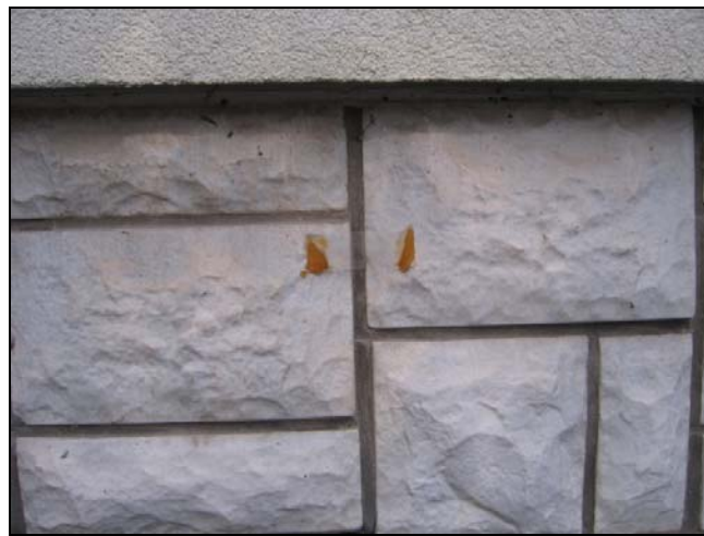
Slika 7: Pogled na razpoko in prvo stekleno plombo na vzhodni strani fasade objekta
