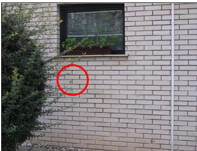
Slika 18: Lokacija razpoke na severnem delu fasade objekta
