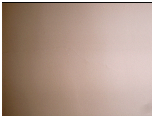
Slika 13: Razpoka na stropu v dnevnem prostoru
