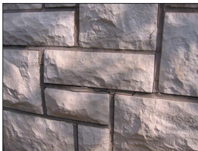
Slika 9: Pogled na razpoke na južni strani fasade
