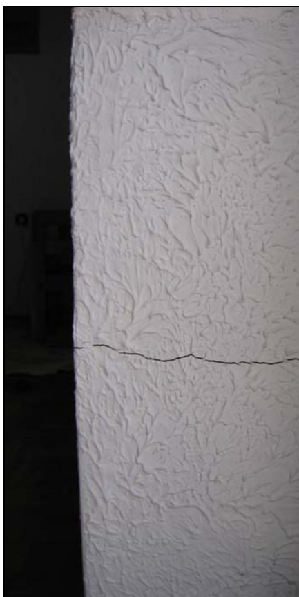
Slika 23: Razpoka na steni v dnevnem prostoru objekta
